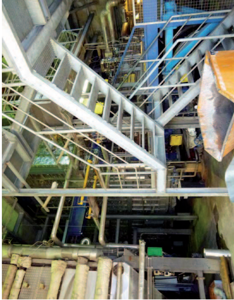
Blick in das Ofen- und Kesselhaus
